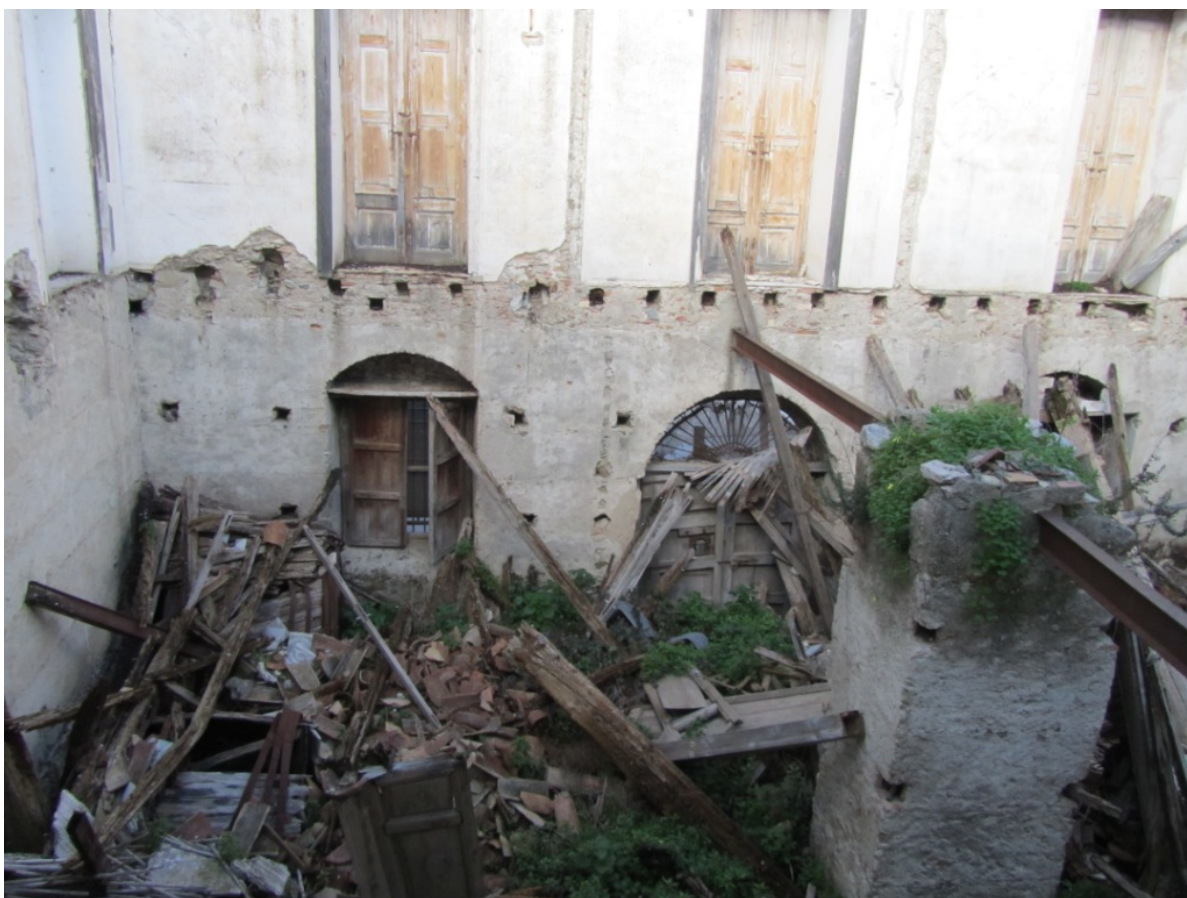
Altra Vista della zona di crollo dei solai e della copertura
