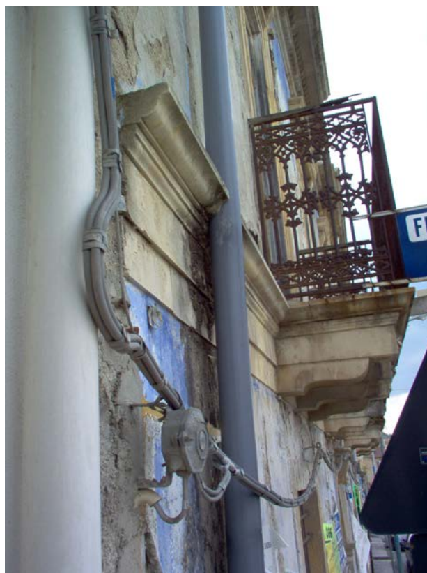
DEGRADO DEL FRONTE SU VIA PRINCIPE UMBERTO
