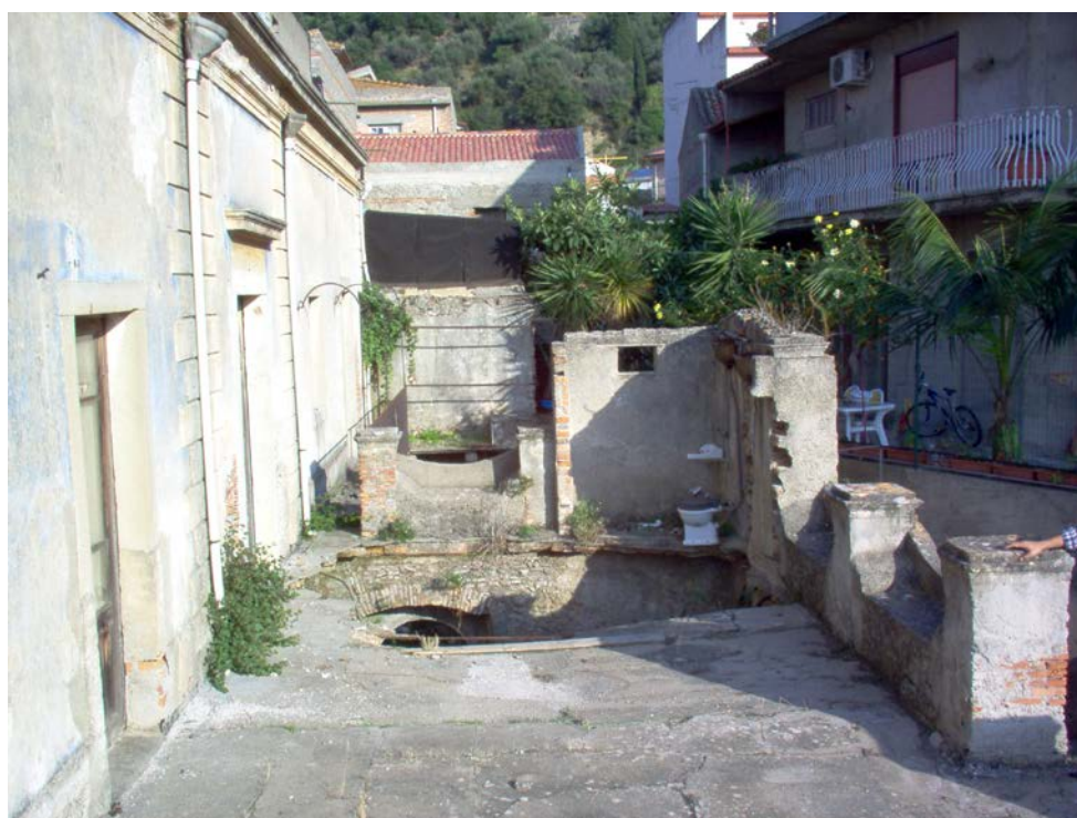
PARTICOLARE SOLAIO CROLLATO
