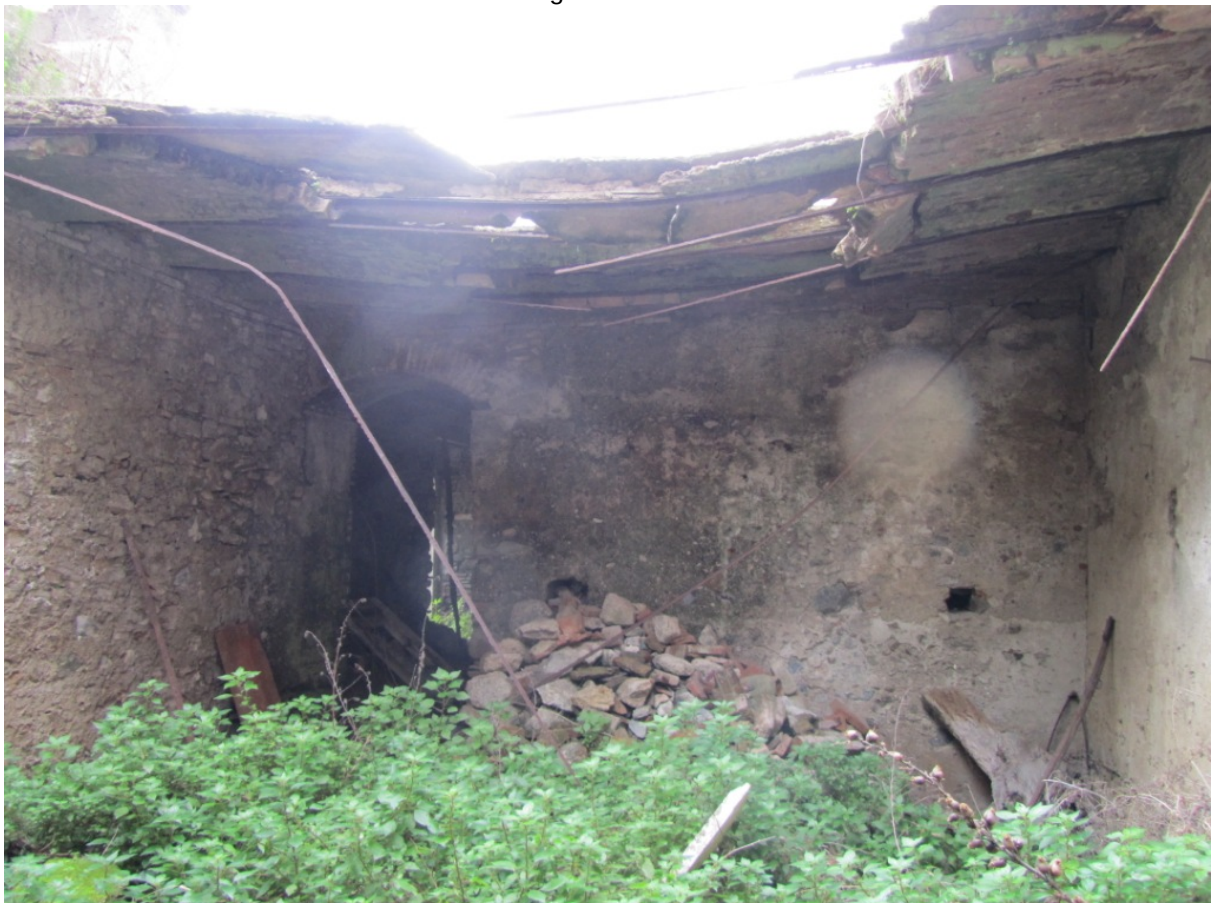
Vista del solaio crollato di copertura del vano retrostante il corpo principale
