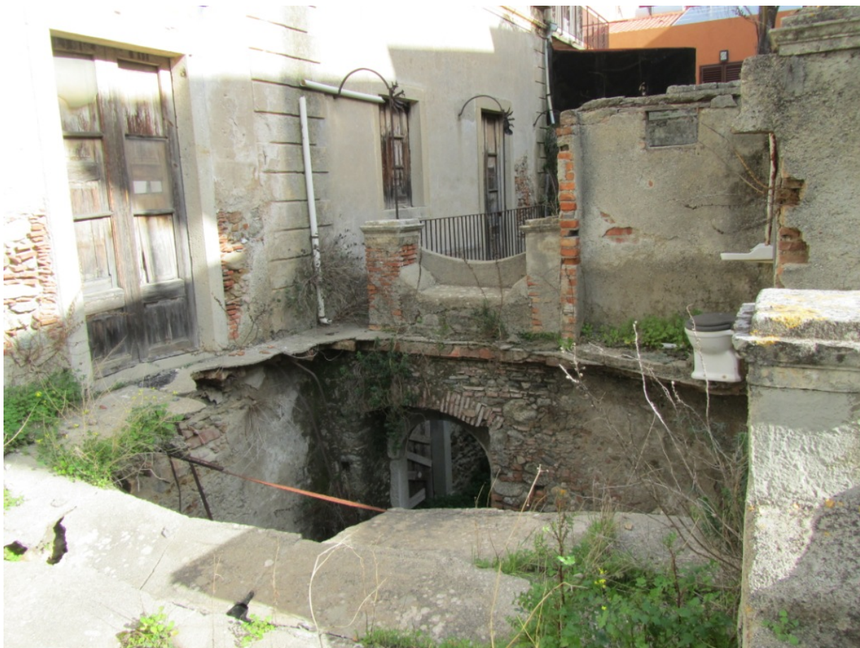
Vista del crollo del solaio di copertura del vano a piano terra retrostante il corpo principale
