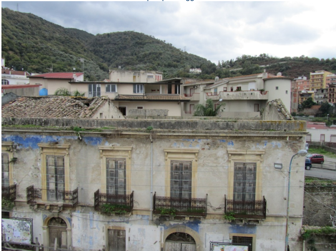
Vista della copertura crollata
