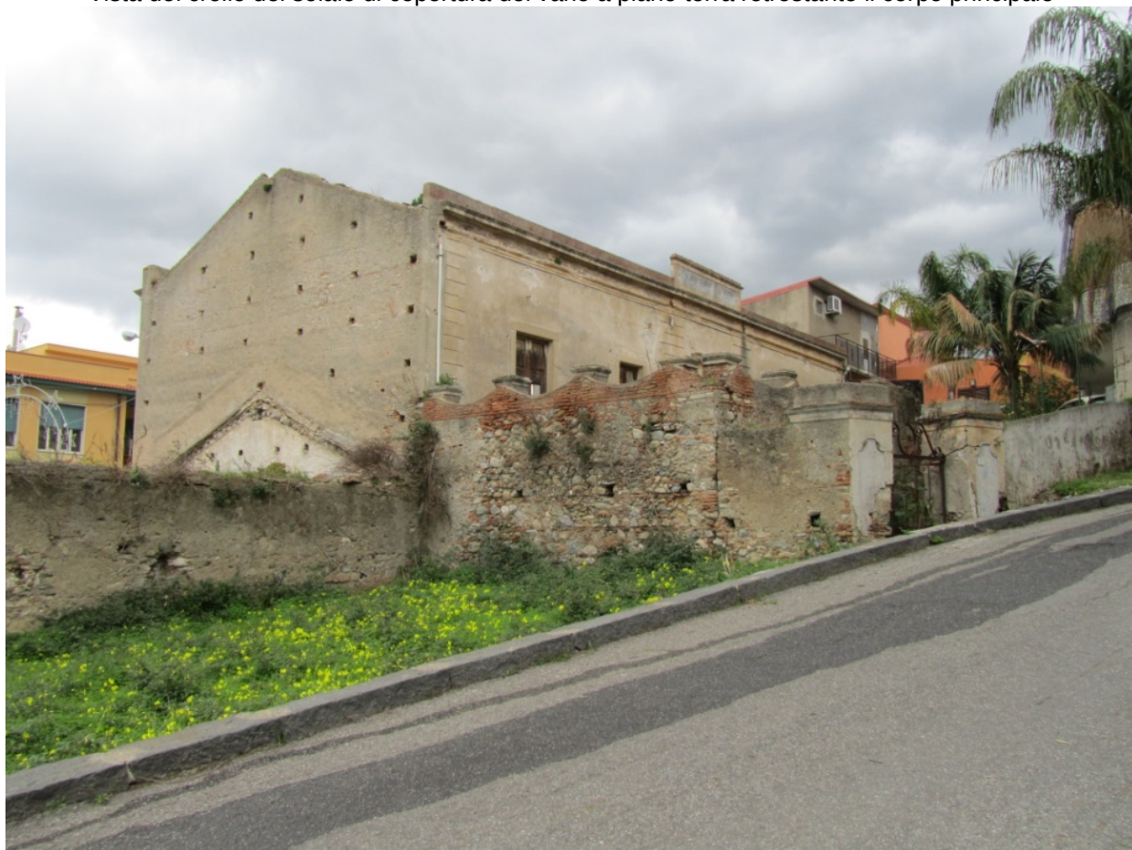
Vista dell'edificio dalla strada retrostante, si nota che anche la copertura dell'edificio confinante è crollato
