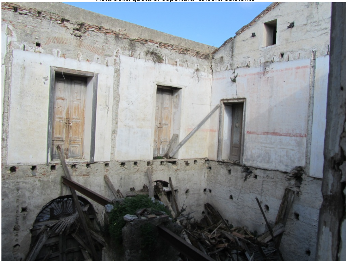
Vista della zona di crollo dei solai e della copertura
