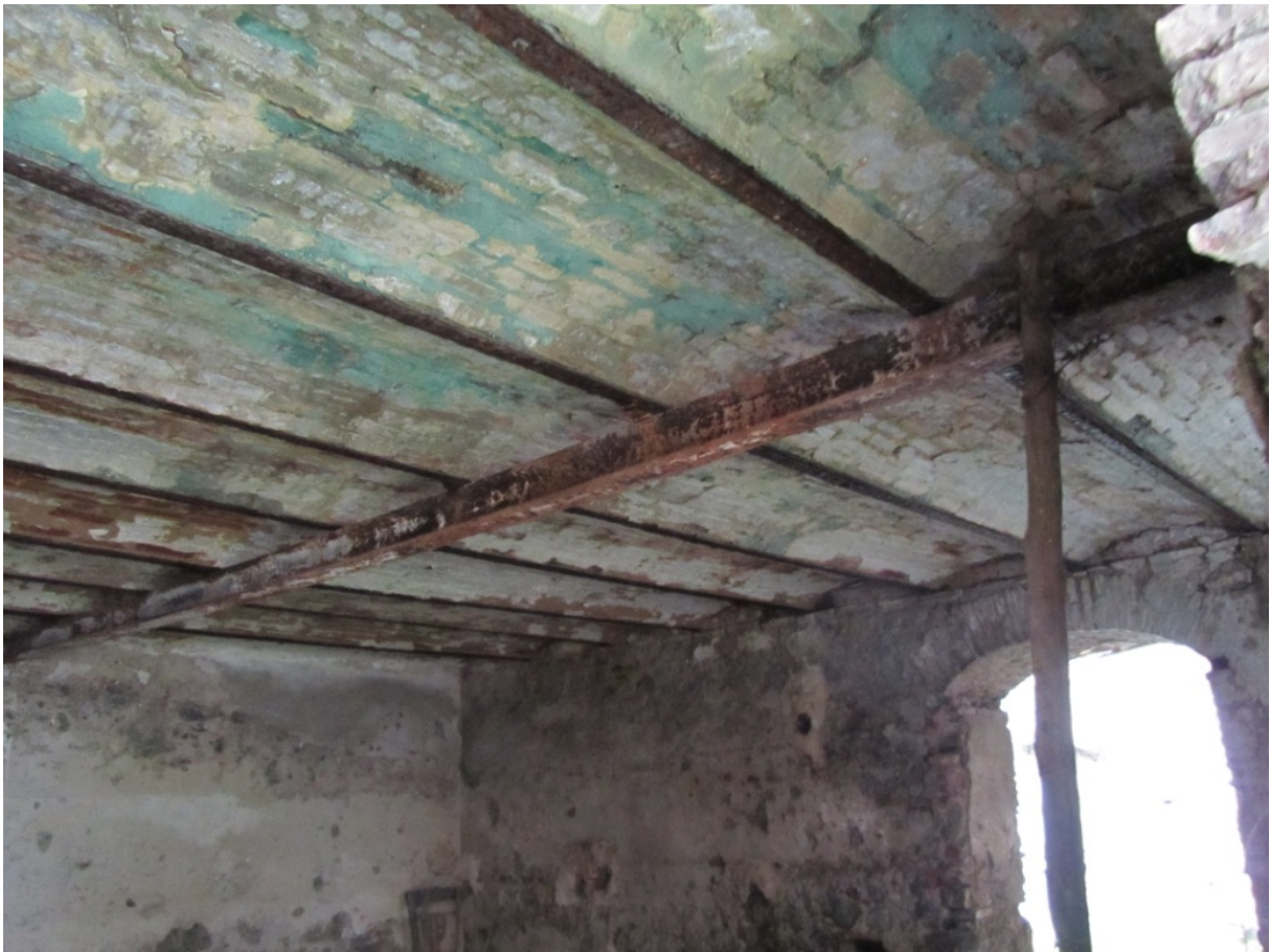
Vista dello stato di degrado dei solai ancora esistenti
